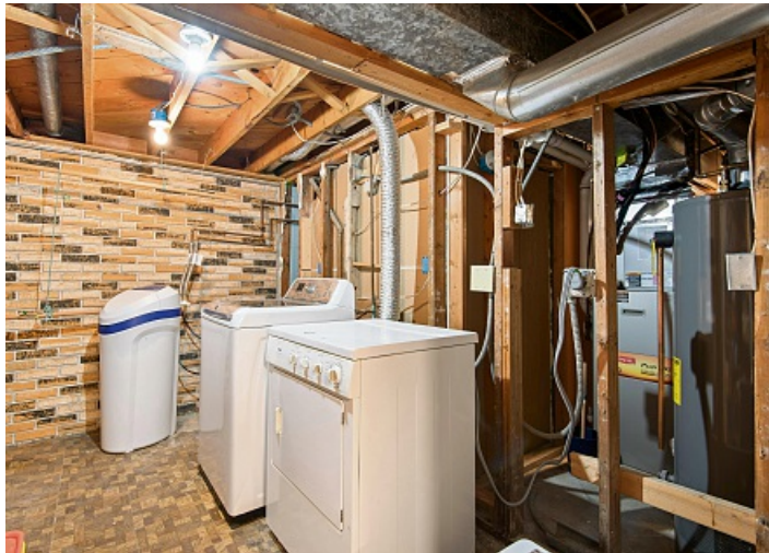
Gut gedämmte Leitungen schützen vor Frost und verhindern teure Wasserschäden. Foto: Pexels
