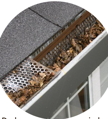
Dach sind gefährlich und sollten vermieden werden. Langfristig kann ein Laubschutzgitter oder eine Rinnenabdeckung die Arbeit deutlich erleichtern. Sie verhindern, dass grobes Material
