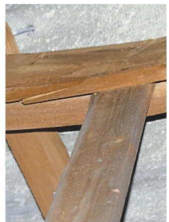
Einer der geborstenen Balken mit einem größeren Wasserfleck. HOLGER HACKENDAHL
