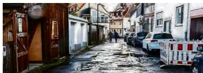
Straßenabschnitt „Hinter den Mauern“: Natursteinpflaster soll den Flickenteppich ersetzen.
