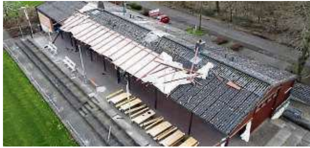
Beschädigtes Dach des Spvvg-Gebäudes: Eine Sanierung ist wohl unausweichlich.
