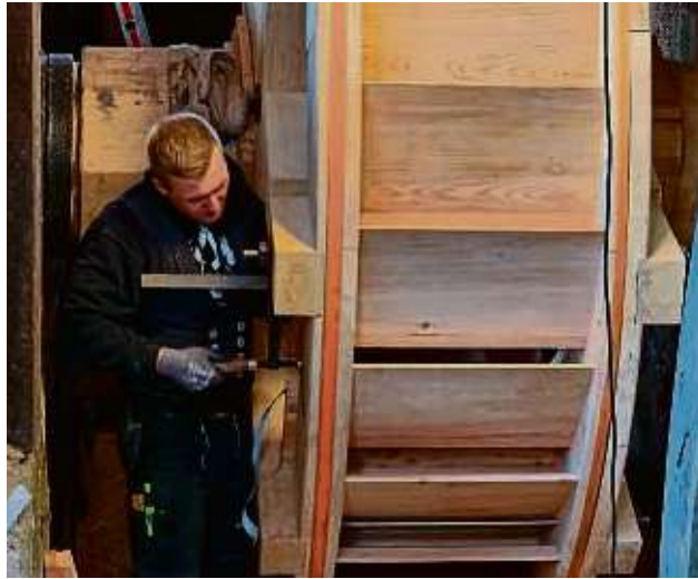
Im Mühlengraben montiert ein Mitarbeiter des aus Sachsen-Anhalt stammenden Mühlenbauers das neue mittlere Rad. FOTO: YFI
