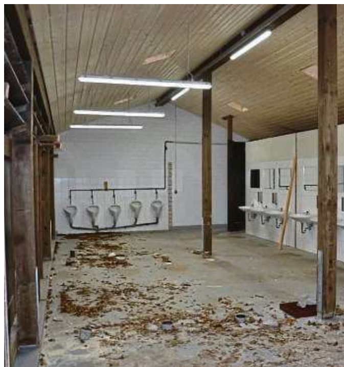
Altes raus, Neues rein: Blick in die Umkleiden und Toiletten während der Bauarbeiten
