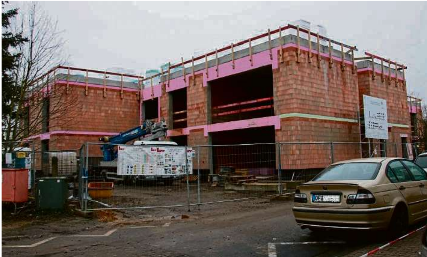
Der Rohbau des neuen Wohnhauses der Behindertenhilfe, das ab Herbst 2021 an der Klein-Krotzenburger Blumenstraße 20 Menschen mit geistiger Behinderung eine neue Heimat bieten soll, konnte trotz Corona planmäßig fertiggestellt werden. Foto: zbo
