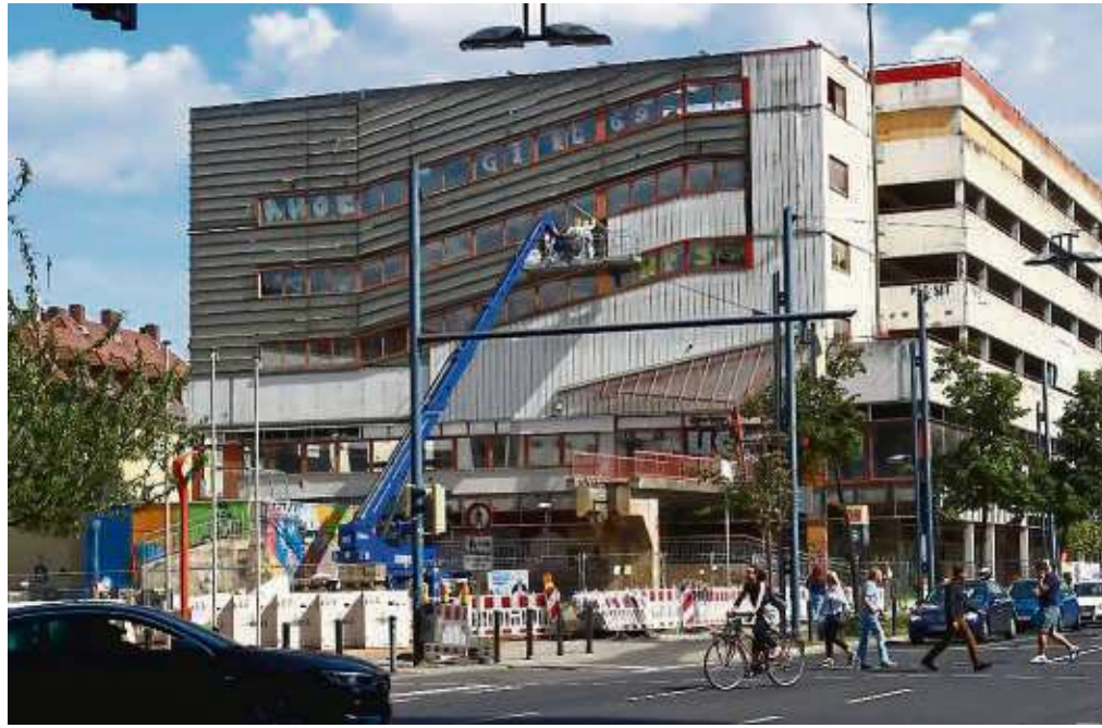
Das ehemalige Toys'R'Us-Gebäudes soll auch dank der Mitwirkung des Gestaltungsbeirats zum ansehnlichen Kernpunkt des Marktplatzes werden.
