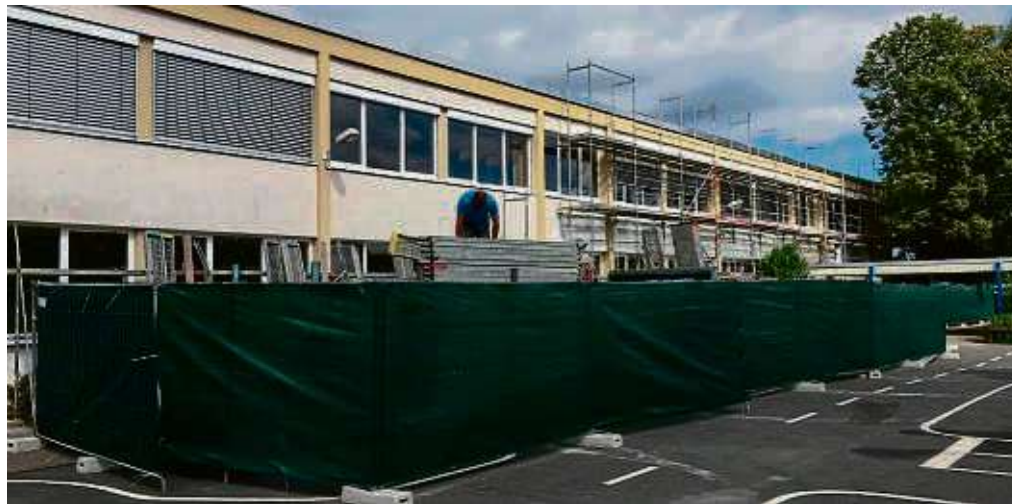
An der Alfred-Delp-Schule im Seligenstädter Stadtteil Froshausen wurden kurz vor Beginn der Sommerferien die Vorbereitungen für ein größeres Sanierungsvorhaben getroffen. Wie Kreissprecherin Ursula Luh mitteilte, steht in den kommenden Monaten eine umfassende energetische Sanierung der Schule an. Dabei werden Fassade und Fenster entsprechend modernisiert. Die finanziellen Mittel in Höhe von etwa einer Million Euro stammen nach Aussage der Kreissprecherin aus dem Kommunalinvestitionsprogramm (KIP), die Arbeiten sollen voraussichtlich bis Oktober dauern. Foto: Signus
