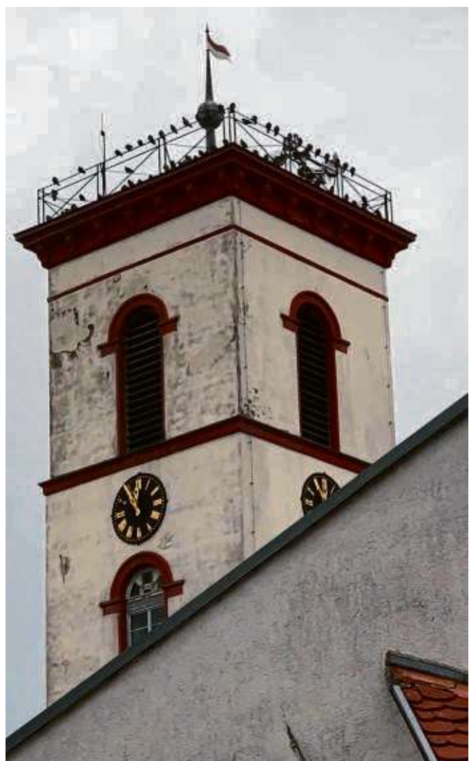
In der Tat. Es ist fünf vor zwölf. Der Rathausurm hat eine Sanierung dringend nötig, die auch geplant ist. Jetzt müssen Seligenstädter und Besucher von außerhalb noch mit einem weniger schönen Anblick vorlieb nehmen. Foto: beko
