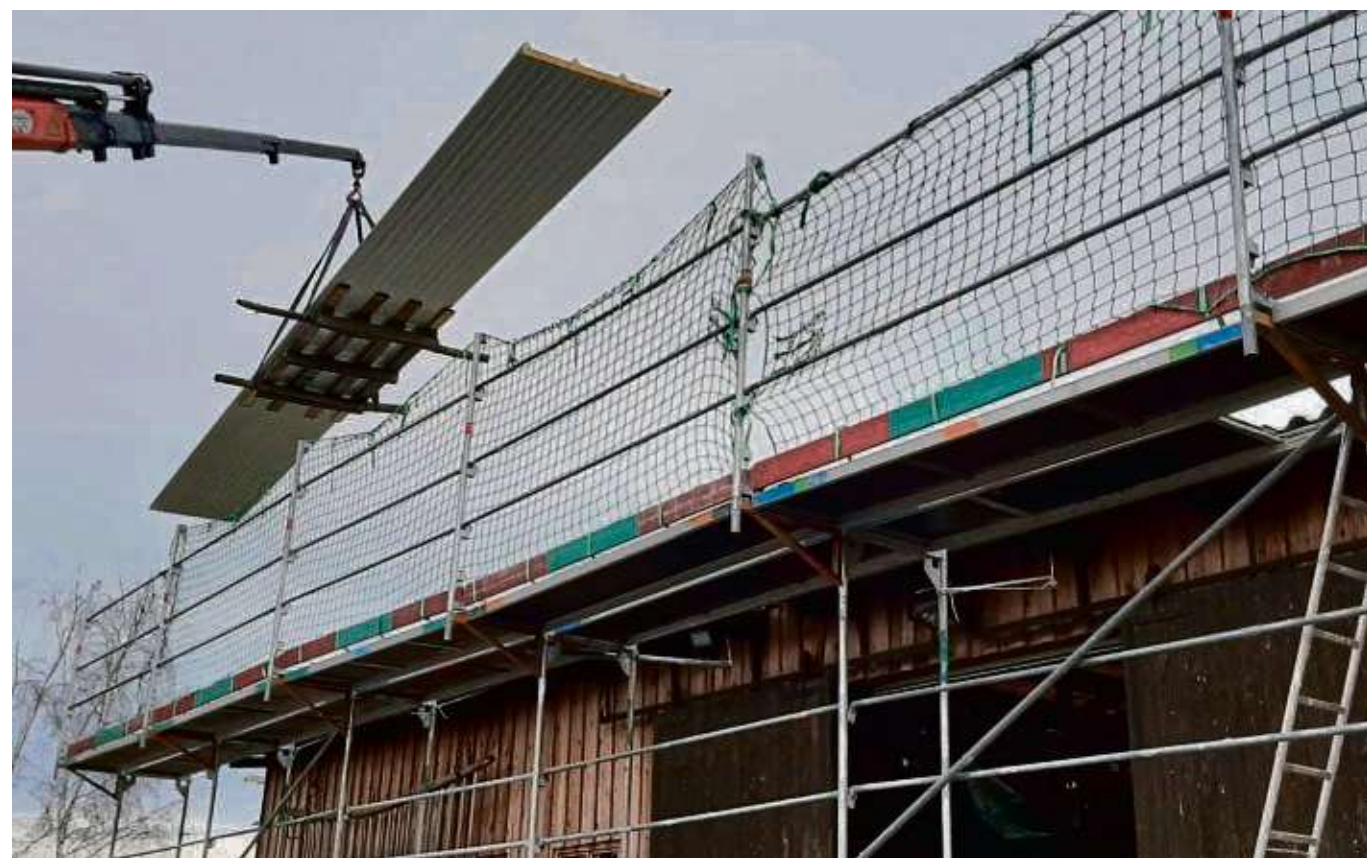
Sturmschäden vom August 2019 beeinträchtigen nach wie vor das Vereinsleben der Traktorenfreunde Seligenstadt. Der Sturm hatte im vergangenen Jahr massive Schäden am Dach der Gerätehalle sowie des Vereinsheimes angerichtet und nun vermehrt zu Ausfällen von Veranstaltungen, wie beispielsweise dem Schlachtfest im Januar, geführt. Gerade in der kalten Jahreszeit ist eine trockene und warme Räumlichkeit unabdingbar. Mittlerweile steht endlich das benötigte Material zur Instandsetzung bereit und viele eifrige Mitglieder hatten sich nun an der noch andauernden Reparatur beteiligt und erhielten zum Dank einen kräftigen Imbiss, den die Metzgerei Franz Becker gestiftet hatte. Nach der Fertigstellung soll das Vereinsleben wieder aufblühen und die zukünftigen Veranstaltungen bekannt gegeben werden.
