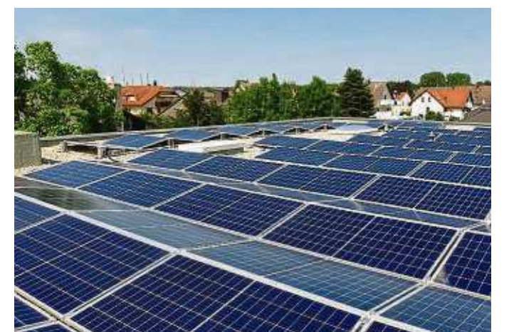
Die Fotovoltaikanlage auf der neugebauten Kindertagesstätte St. Margareta Froschhausen.
