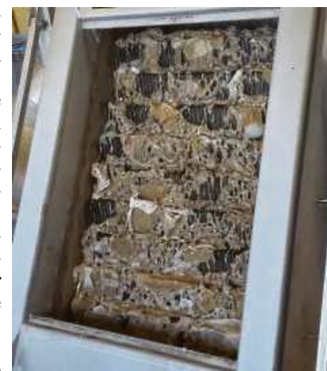
Ärgerlich: Feuchttücher im Pumpwerk. Foto: p
