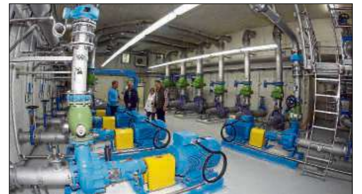
Das unterirdische Pumpwerk zu Füßen des Steinheimer Tors in Seligenstadt ist ans Netz gegangen.
