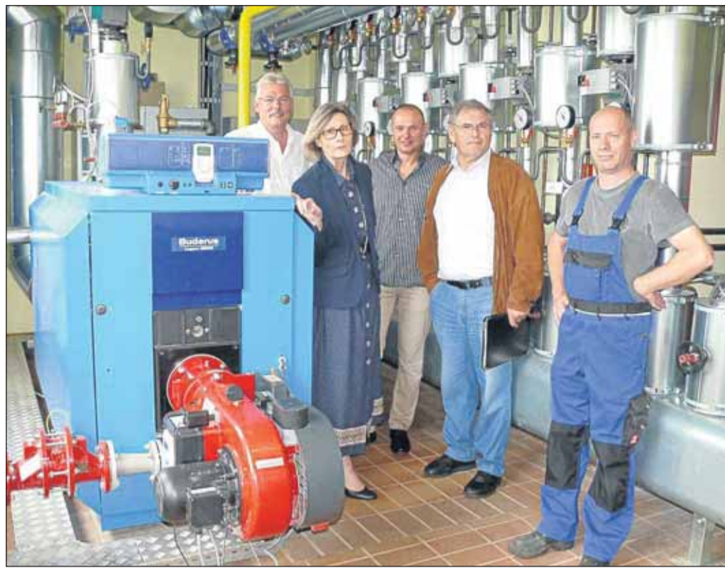
Stolz auf das neue Blockheizkraftwerk (BHKW) zur Erzeugung von Strom, der einen großen Teil des Strombedarfs der Kläranlage und des Bauhofes abdeckt, ist Bürgermeisterin Dagmar B. Nonn-Adams, hier mit Bauhofleiter Harald Oldt (links) im Kreis von Mitarbeitern. Foto: Rake
