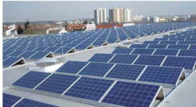
Auf dem Dach der neuen Lagerhalle von HolzLand Becker wurde eine moderne Photovoltaikanlage errichtet, die jährlich mehr als 225.000 Kilowatt-Stunden Strom produziert.
