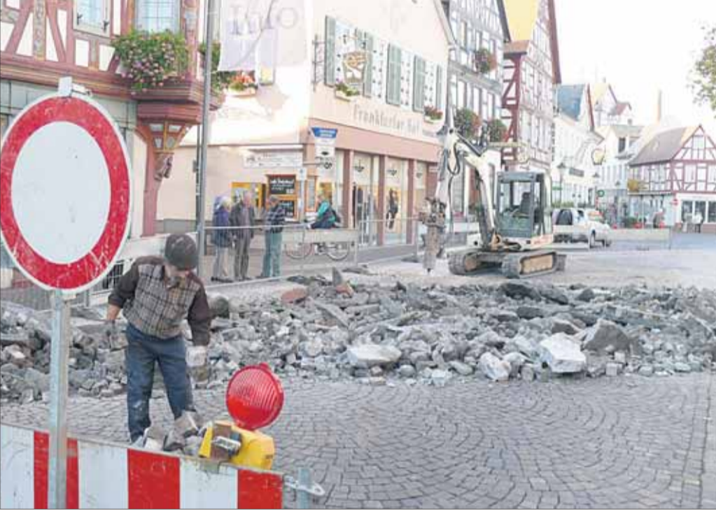
Eine U-Bahn für Seligenstadt? Leider, nein! Wie Erste Stadträtin Claudia Bicherl mitteilt, ist eine Durchfahrt über den Marktplatz in Richtung Aschaffener Straße bis 18. November 2011 nicht möglich. Aufgrund von dringenden Sanierungsarbeiten des Kopfsteinpflasters in Höhe der Wolfstraße ist dies erforderlich. Die Stadträtin bittet um Verständnis. Foto: Rack
