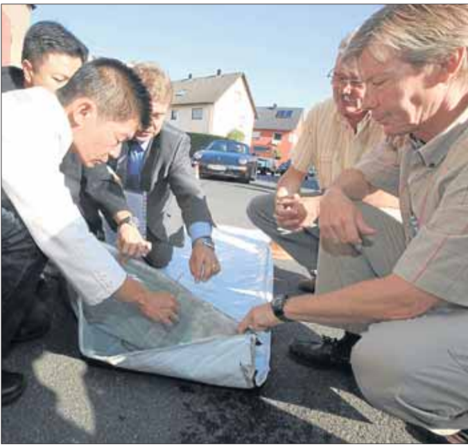
Im Inliner-Verfahren werden 1300 Meter Rohrleitungen verlegt - das interessiert diese fern angereisten Techniker sehr. Foto: paw
