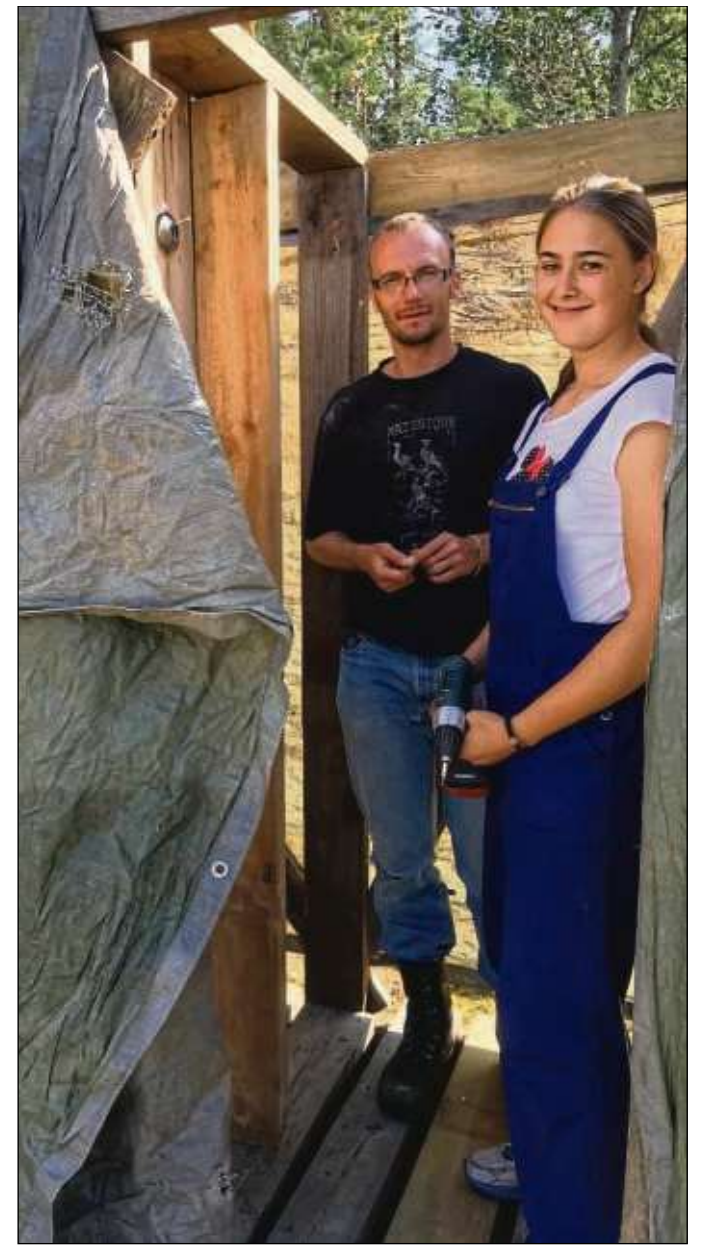
Gemeinsam mit ihrem Kollegen aus Estland baute Barbara eine beheizbare Dusche für den Außenbereich.
