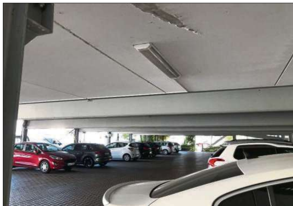
Erneuter Vandalismus-Fall im Seligenstädter Altstadtparkhaus am Steinheimer Tor: Zum zweiten Mal in kürzester Zeit beschädigten Unbekannte die LED-Deckenlampen. Foto: beko
